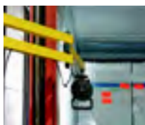
LUZ LED PARA ZONA DE CARGA
