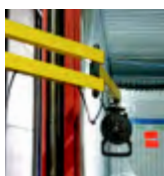
LUZ LED PARA ZONA DE CARGA
